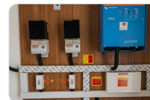
Système solaire — Kaédi
