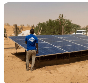
Pompage hybride · Tiguent
